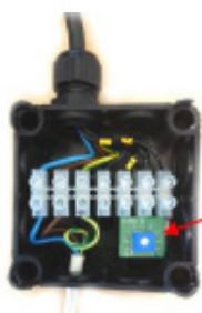
Kopplingsdosa med potentiometer är placerad bakom fläktens kåpa (varvtalsreglering, 0-10V)
