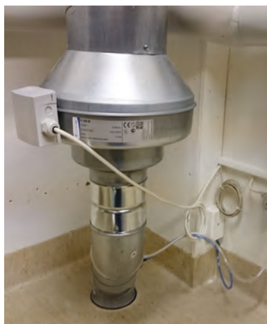
Monterad fläkt inomhus
