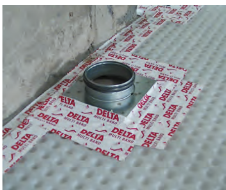
34. Färdig monterad sugpunkt.
